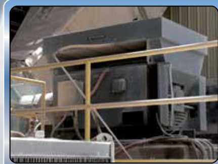
Preheater ID Fan
