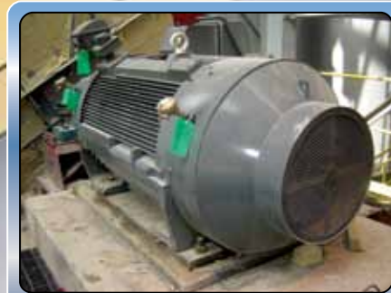
Baghouse ID Fan
