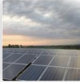
Ergolding, Munchen, DE 1,420 MW
