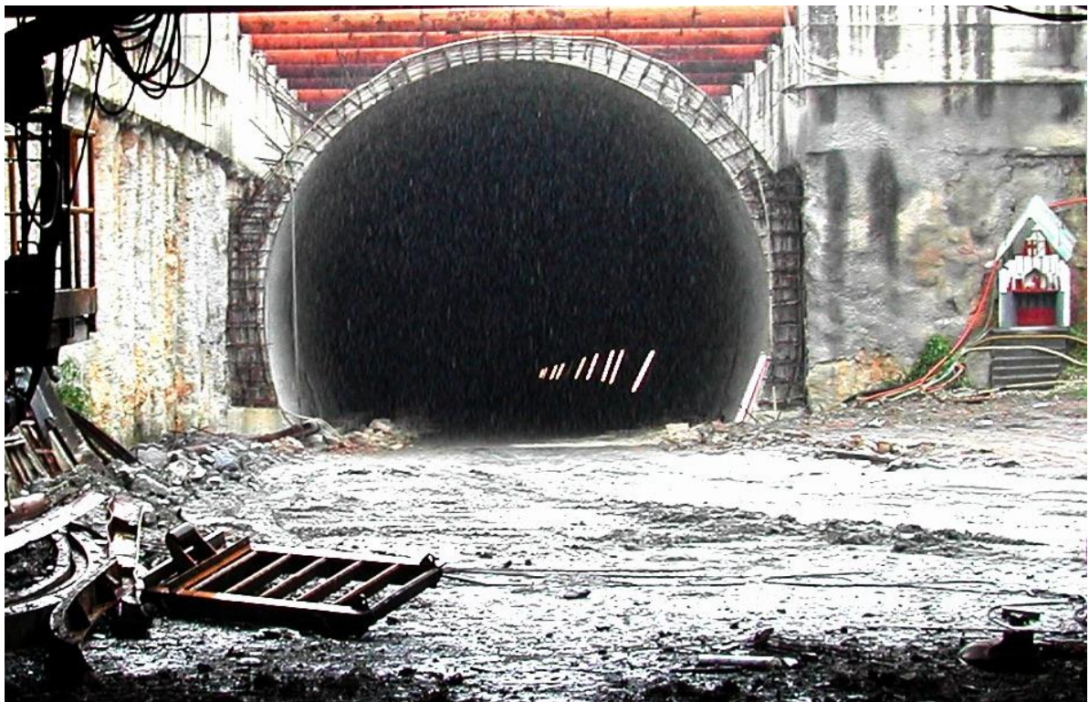
Falso túnel construido y pronto para ser enterrado y restituir el área ocupada por la trinchera
