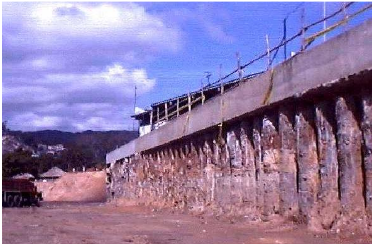
Sector final de la pared Norte contenida por muro de pilotes en cantiléver
