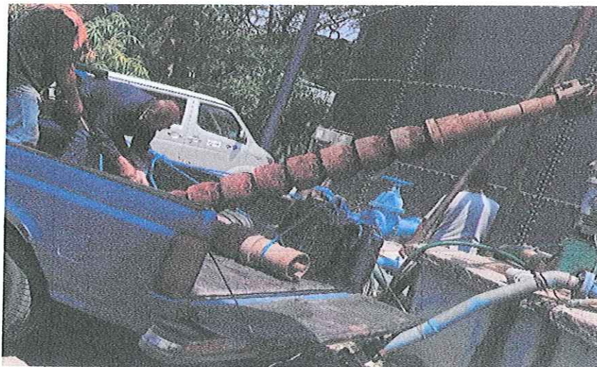
"SERVICIO DE REHABILITACION DE BOMBA, REBOMBEO TECNOLÓGICO, LOCALIZADO EN PERIFERICO NORTE DE LA CIUDAD DE IGUALA GRO".
