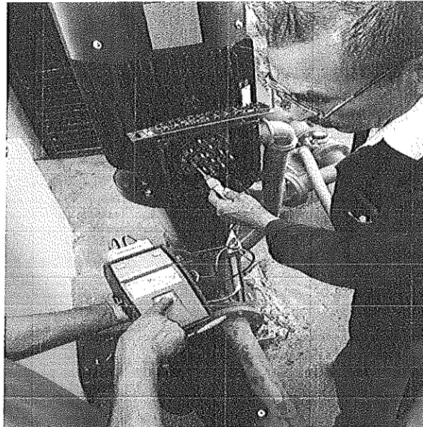
"SUMINISTRO, MONTAJE ELECTROMECANICO Y PRUEBAS DE UNA NUEVA BOMBA VERTICAL MULTIPASOS 40 HP/440V, EN REBOMBEO ACUAFERICO HEBERTO-MIRADOR, LOCALIZADO EN LA COL. HEBERTO CASTILLO, DE IGUALA GRO".
