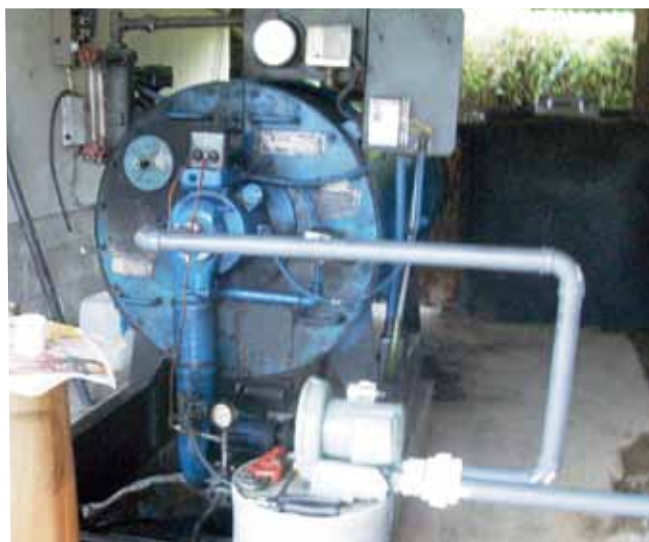
Fotografía 4. Caldera utilizando biogás..
