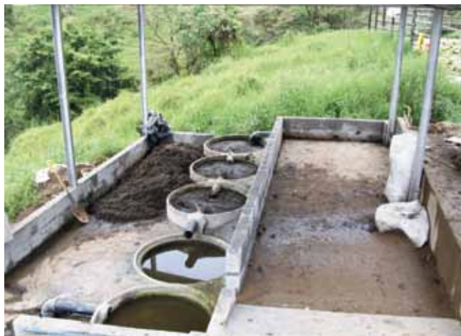
Fotografía 2. Sistema de separación de sólidos, tipo flotación, en funcionamiento.
