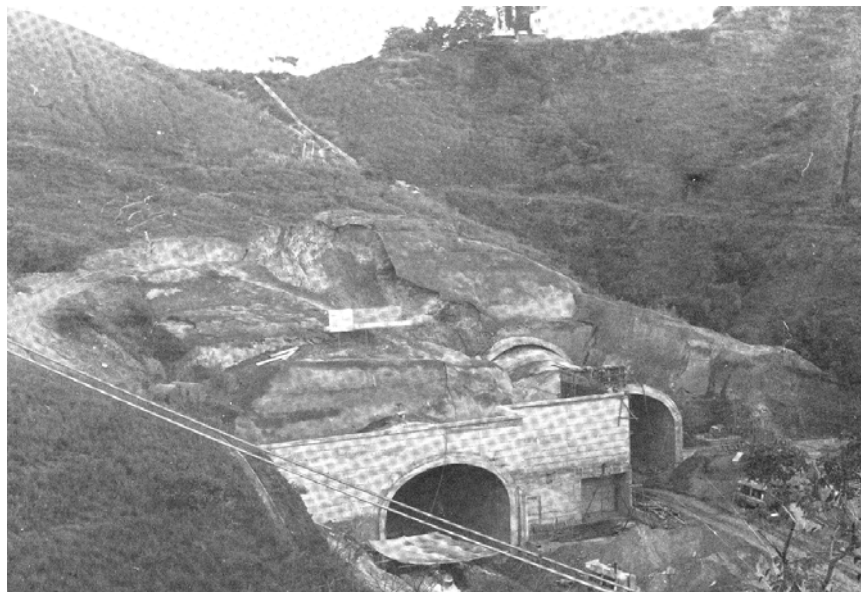
Túnel La Trinidad – Portal La Trinidad – Deslizamientos en superficie durante la construcción
