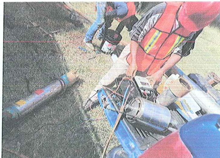
MONTAJE ELECTROMECANICO DE UNA BOMBA SUMERGIBLE 30 HP/220V- 54 MT DE COLUMNA ACERO AL CARBON 4", REPARADA PROPIEDAD DE CAPAMI, EN BOMBEO POZO PROFUNDO SAN GERARDO , LOCALIZADO EN CALLE GARCIA DE LA CADENA , ESQUINA CALLE DEL HUERTO, DE ESTA CIUDAD DE IGUALA GRO.
