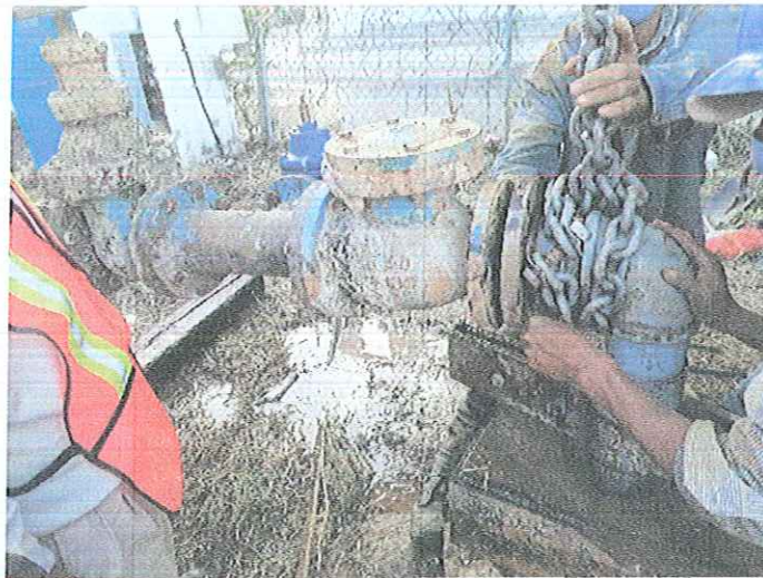
MONTAJE ELECTROMECANICO DE UNA BOMBA SUMERGIBLE 30 HP/220V- 54 MT DE COLUMNA ACERO AL CARBON 4",REPARADA PROPIEDAD DE CAPAMI,EN BOMBEO POZO PROFUNDO SAN GERARDO , LOCALIZADO EN CALLE GARCIA DE LA CADENA , ESQUINA CALLE DEL HUERTO, DE ESTA CIUDAD DE IGUALA GRO.
