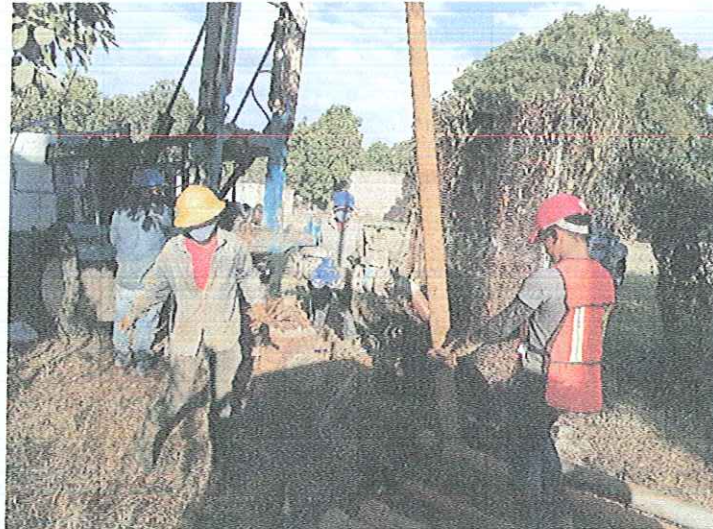
MONTAJE ELECTROMECANICO DE UNA BOMBA SUMERGIBLE 30 HP/220V- 54 MT DE COLUMNA ACERO AL CARBON 4",REPARADA PROPIEDAD DE CAPAMI,EN BOMBEO POZO PROFUNDO SAN GERARDO , LOCALIZADO EN CALLE GARCIA DE LA CADENA , ESQUINA CALLE DEL HUERTO, DE ESTA CIUDAD DE IGUALA GRO.
