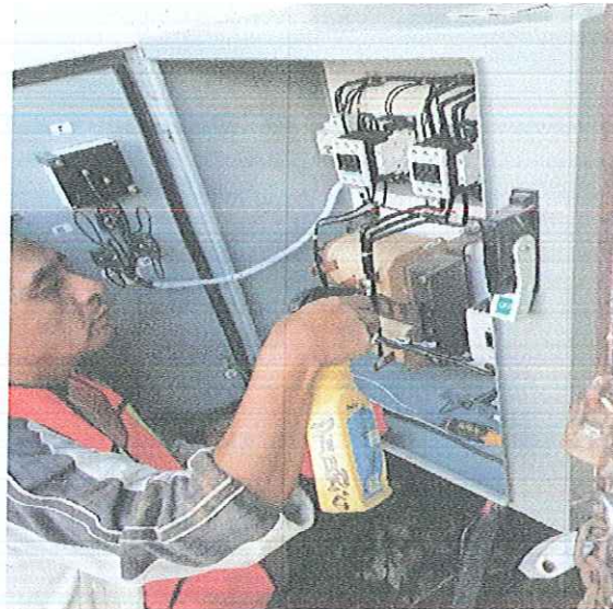
MONTAJE ELECTROMECANICO DE UNA BOMBA SUMERGIBLE 30 HP/220V- 54 MT DE COLUMNA ACERO AL CARBON 4",REPARADA PROPIEDAD DE CAPAMI,EN BOMBEO POZO PROFUNDO SAN GERARDO , LOCALIZADO EN CALLE GARCIA DE LA CADENA , ESQUINA CALLE DEL HUERTO, DE ESTA CIUDAD DE IGUALA GRO.
