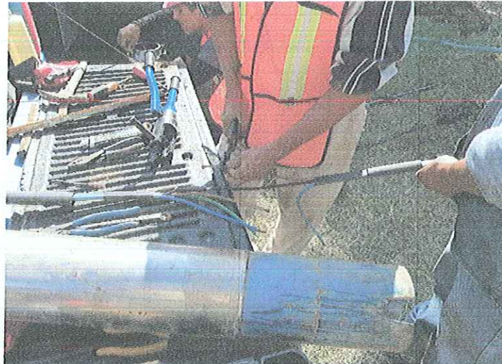
MONTAJE ELECTROMECANICO DE UNA BOMBA SUMERGIBLE 30 HP/220V- 54 MT DE COLUMNA ACERO AL CARBON 4", REPARADA PROPIEDAD DE CAPAMI, EN BOMBEO POZO PROFUNDO SAN GERARDO, LOCALIZADO EN CALLE GARCIA DE LA CADENA, ESQUINA CALLE DEL HUERTO, DE ESTA CIUDAD DE IGUALA GRO.
