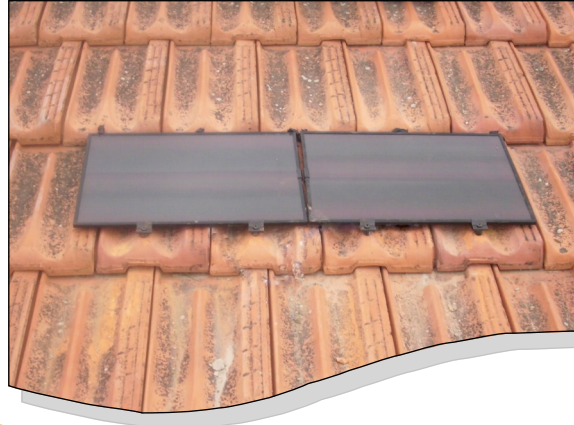
Panel solar colocado en el tejado
