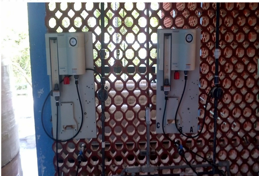
EQUIPOS DE CLORACIÓN
