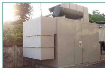
發電機隔音罩
