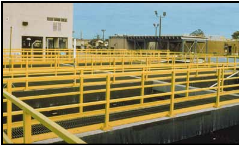
Los barandales de tubo cuadrado fabricados con componentes que son productos Dynaform ofrecen una larga vida útil en el entorno corrosivo de esta planta de tratamiento de aguas residuales.
