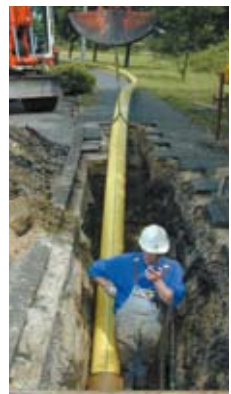
Tuberías de gas y...
