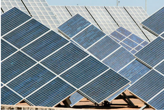
Imagen 3. Celdas fotovoltaicas. Autor y año desconocido.
