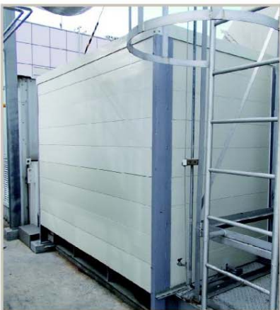
屋頂設備隔音牆
