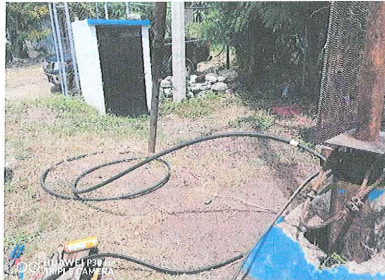
MONTAJE ELECTROMECANICO DE UNA BOMBA SUMERGIBLE 30 HP/220V- 84 MT DE COLUMNA ACERO AL CARBON 4", EN BOMBEO POZO PROFUNDO 1 MYO LOCALIZADO EN LA COL. 1 MYO DE ESTA CD. IGUALA GRO
