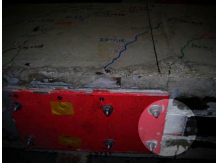
Ilustración 14.- Fallo por cohesión interna del adhesivo en zona de dispositivo de anclaje. Ensayo de sistema de postesado adherido de MBrace LAMINATE
