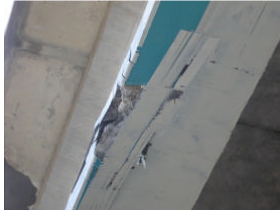
Ilustración 9.- El refuerzo adherido fuera de servicio, de nuevo, por impacto. La estabilidad estructurada estaba garantizada, al contrario hubiera provocado colapso.
