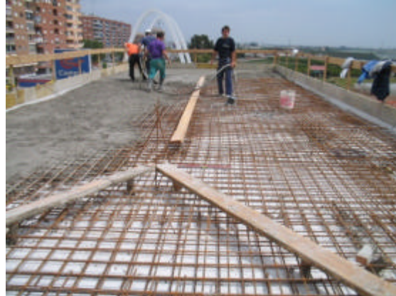
Ilustración 11.- Losa en voladizo con mala ejecución, con pérdida completa de brazo mecánico a negativos. Posteriormente el refuerzo se planteó ante problemas de ELS.
