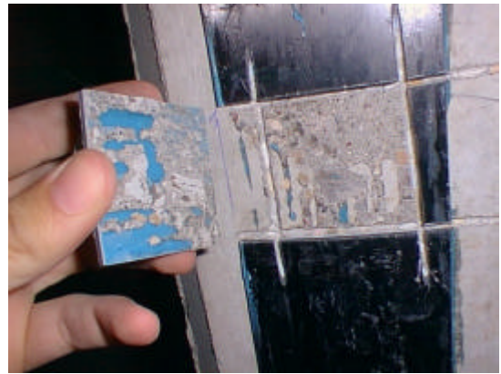
Ilustración 16. Fallo por mala aplicación con oclusión de aire y burbujas. Ensayo de control de aplicación.
