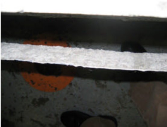
Ilustración 12.- Agotamiento del refuerzo por arrancamiento de hormigón.
