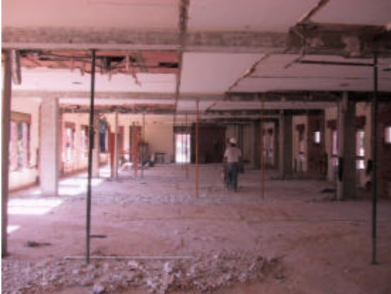
Ilustración 10.- Jácenas con necesidad de refuerzo por incumplimiento de ELS, y grandes cuantías requeridas de MBrace.
