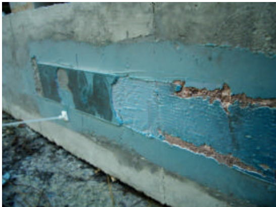
Ilustración 15. Fallo del refuerzo por mala aplicación entre capas sucesivas de adhesivo, por aplicación en temperaturas frías.
