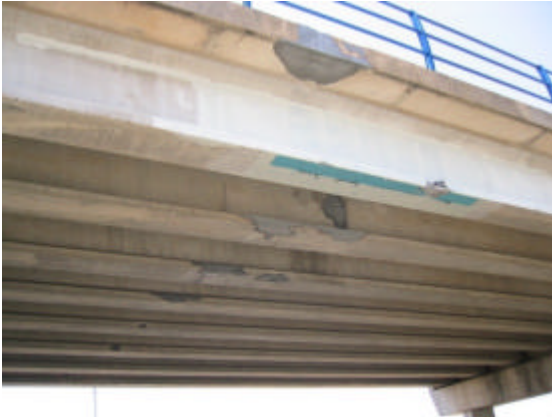
Ilustración 8.- Refuerzo a flexión del puente para reparar el daño originado por impacto.
