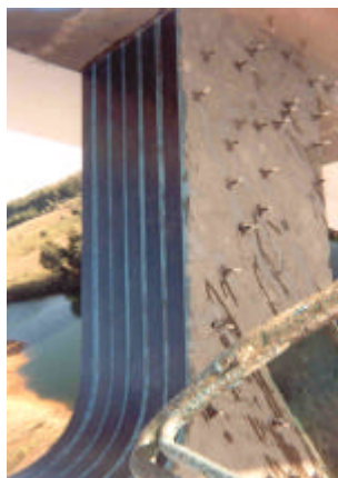
Ilustración 3.- Refuerzo en paramento cóncavo, para cosido de esfuerzos previa inyección de fisuras. La fisuración se produce por acción de pretensado sobre hormigón no suficientemente endurecido.
