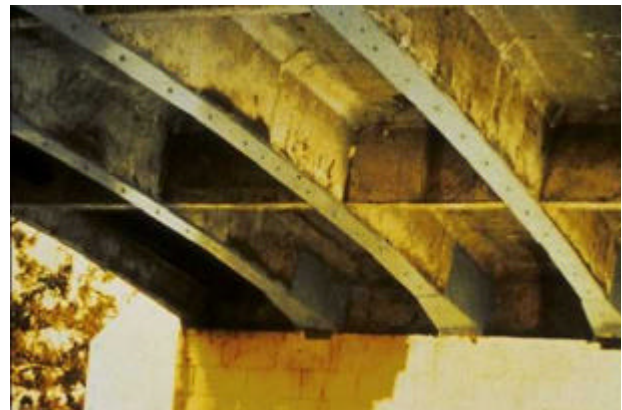
Ilustración 2.- Necesidad de protección de chapas de acero expuestas en ambientes agresivos.
