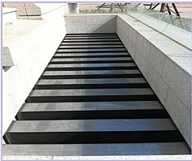
通風豎井消音箱
