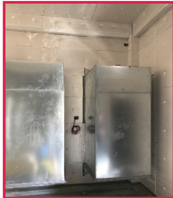
進氣消音箱 (確保進氣的同時可以消音)
