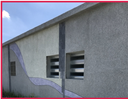
機房外消音箱內縮於牆內 (確保下雨時雨水不滲漏入機房內)
