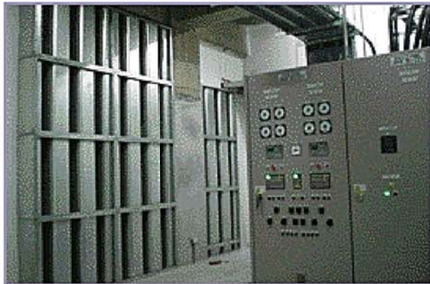
發電機進氣消音箱
