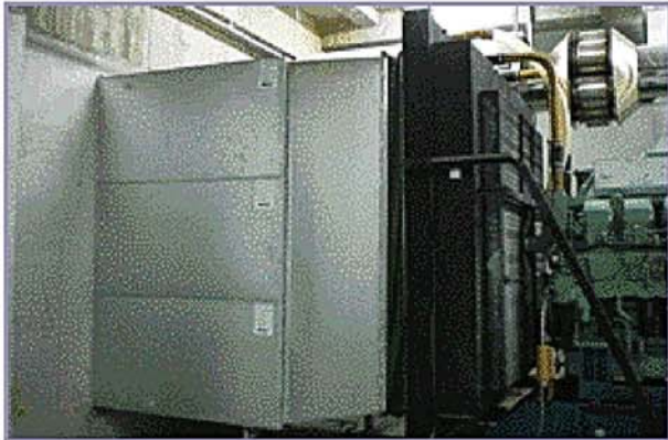
發電機排氣消音箱
