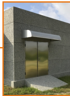
隔音門及雨遮 (隔音門保障機房外安寧/雨遮避免雨水滲漏))
