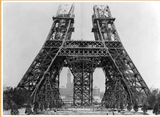
Chantier de la tour Eiffel Malgré les difficultés qu'il connaît, le compagnonnage relève le défi de la modernité : entre 1887 et 1889, une quarantaine de Compagnons Charpentiers lèvent le monument, haut de 300 m à l'époque. Collection Tour Eiffel
